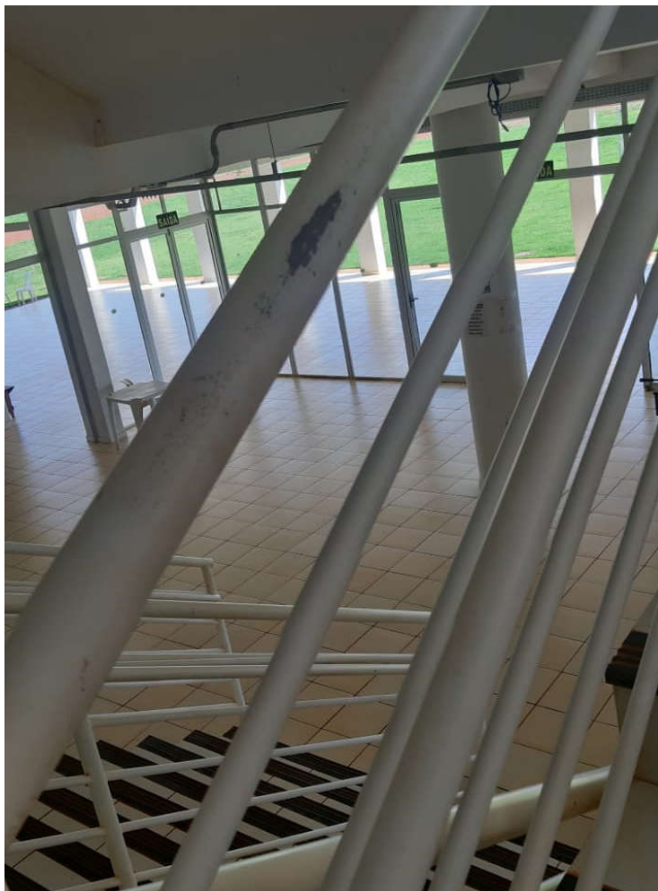
Figura 22: Corrimão / Guarda-Corpos da escada de acesso aos pavimentos, precisa refazer a pintura.
