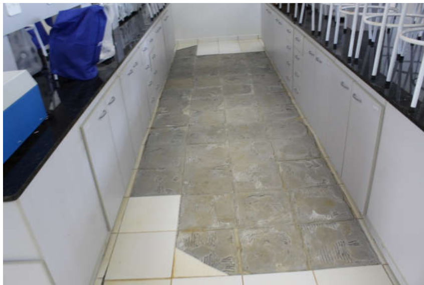
Figura 17: Peças cerâmicas descoladas.
