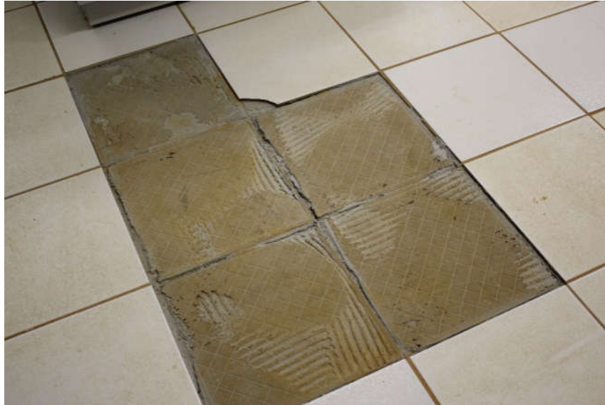
Figura 14: Peças cerâmicas descoladas.
