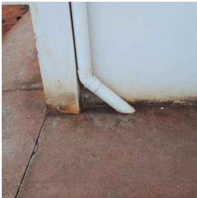
Figura 23: Descida pluvial. Necessária a instalação de joelhos de 100 mm rente a calçada por inexistir rede pluvial no Campus.
