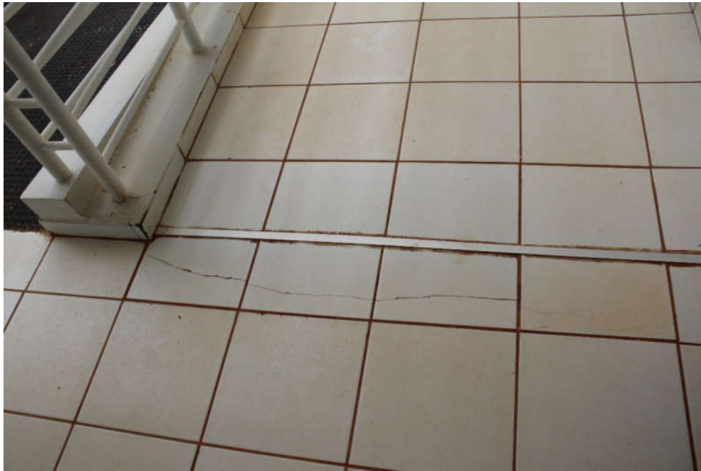
Figura 7: Junta de Dilatação necessitando de recuperação.
