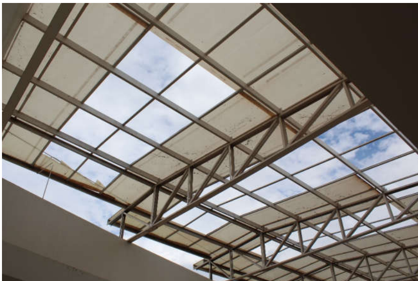
Figura 10: Cobertura com as várias telhas de polycarbonato que foram arrancadas devido ao vento.
