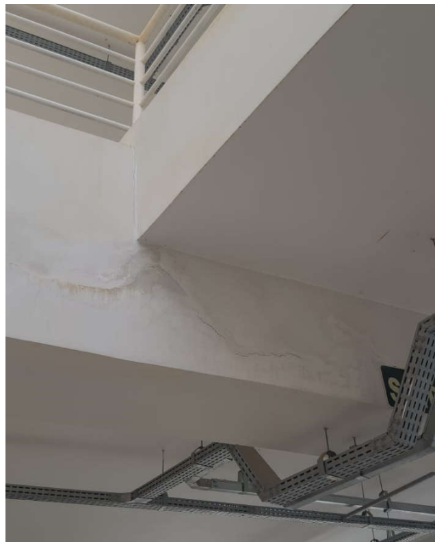
Figura 8: Andar inferior com marcas de infiltração devido à ausência de estanqueidade da Junta de Dilatação. O selante encontra-se ressecado.
