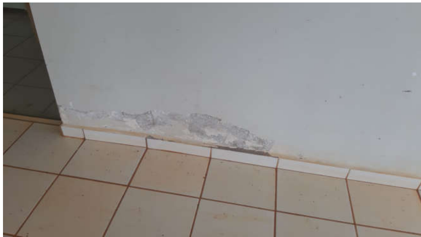
Figura 25: Anomalia da pintura no 1º pavimento, ocasionadas provavelmente devido a umidade por capilaridade por falta de impermeabilização das vigas de baldrame.
