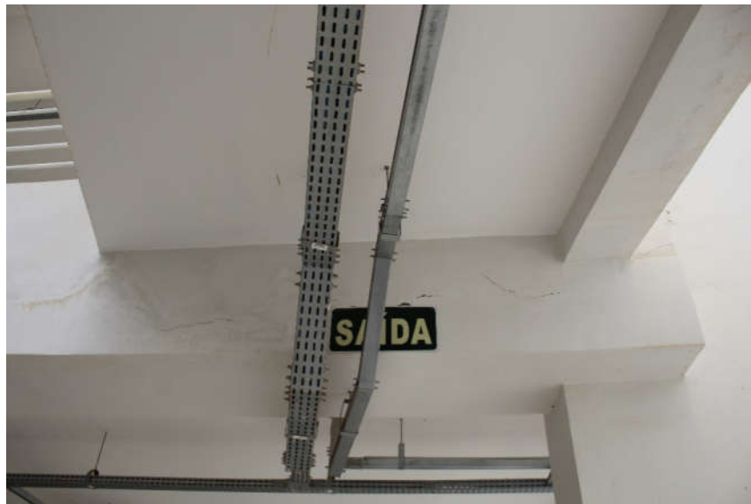
Figura 6: Viga estrutural com trinca superficial na zona de dilatação do prédio.
