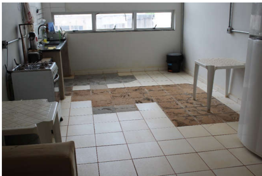
Figura 18: Peças cerâmicas descoladas.
