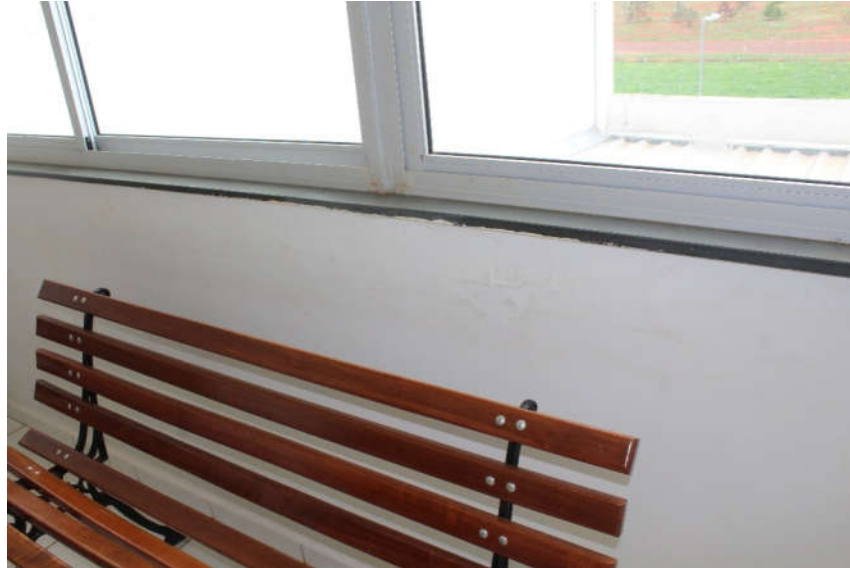
Figura 26: Pequenas trincas na alvenaria, ocasionada pela movimentação da estrutura.
