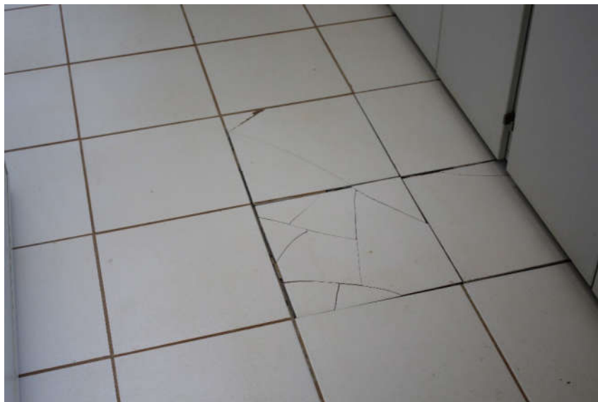
Figura 19: Peças cerâmicas quebradas.
