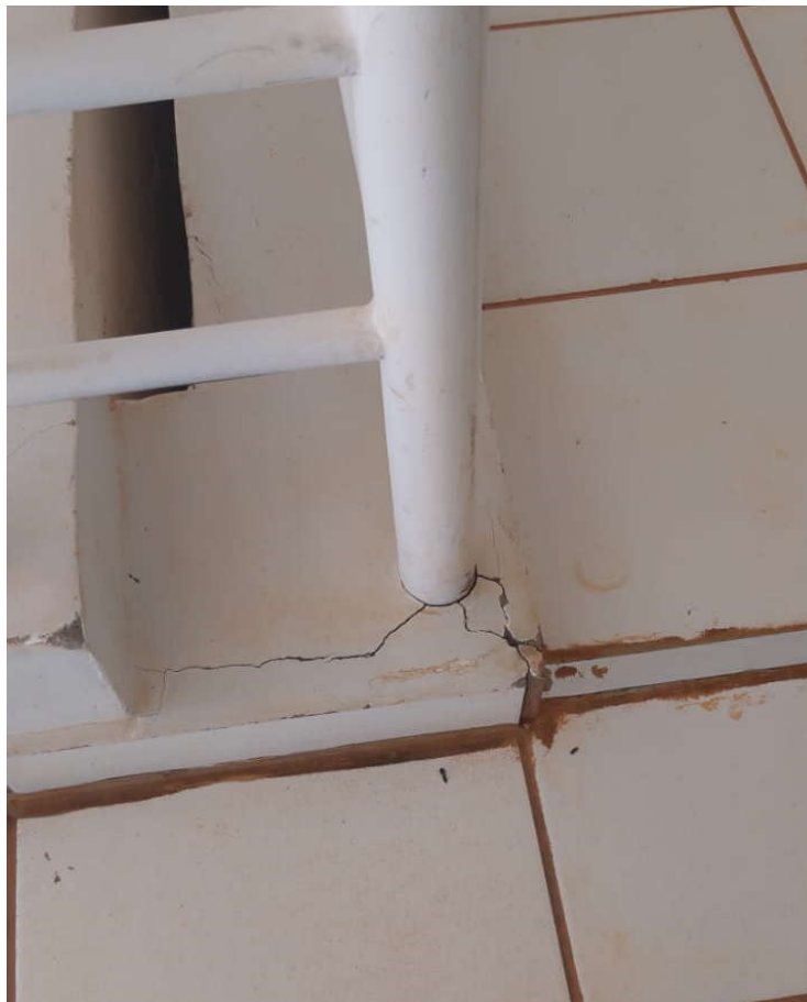
Figura 21: Fixação do Corrimão / Guarda-Corpos em vários pontos da edificação estão com trincas.
