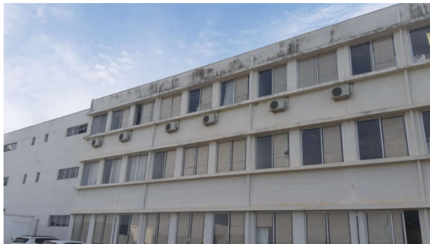
Figura 3: Paredes externas que necessitam de recuperação.
