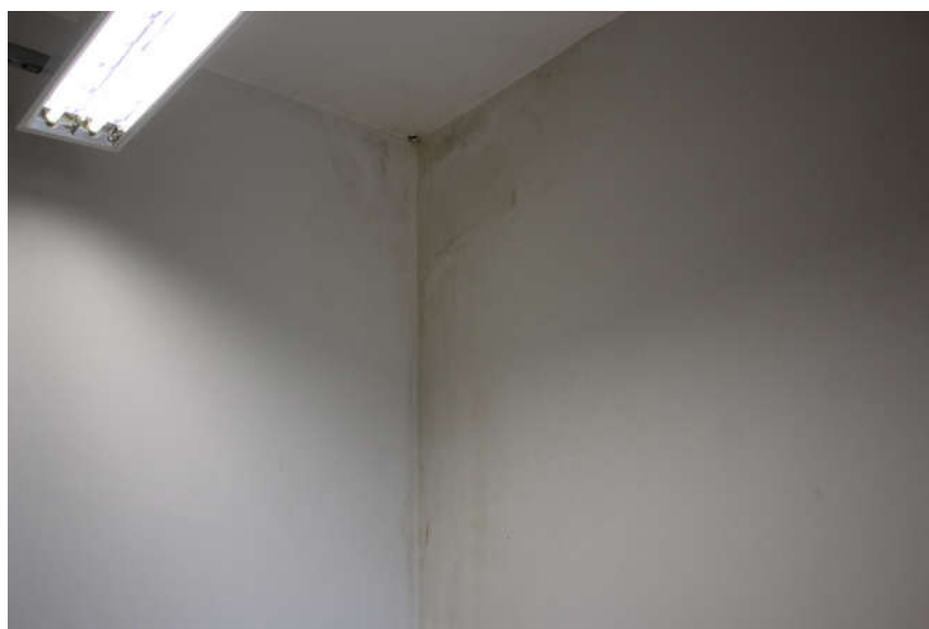
Figura 30: Umidade na sala 1 dos professores no último pavimento, ocasionadas provavelmente, devido a calha obstruída.
