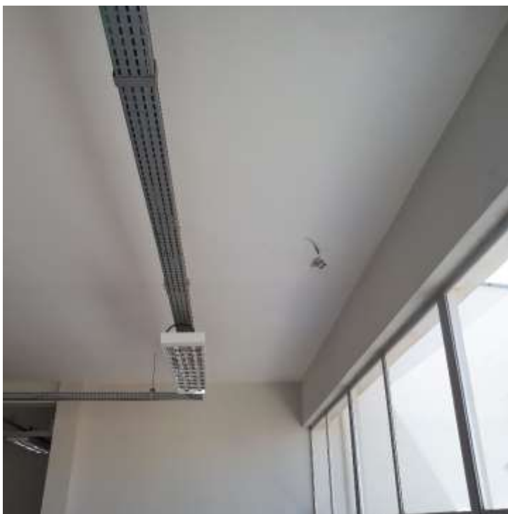
Figura 14: Danos no revestimento de teto devido a percolação de água pelo telhado.
