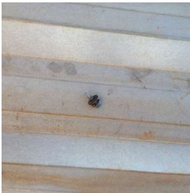
Figura 12: Desprendimento de parafusos de fixação de telhas metálicas.
