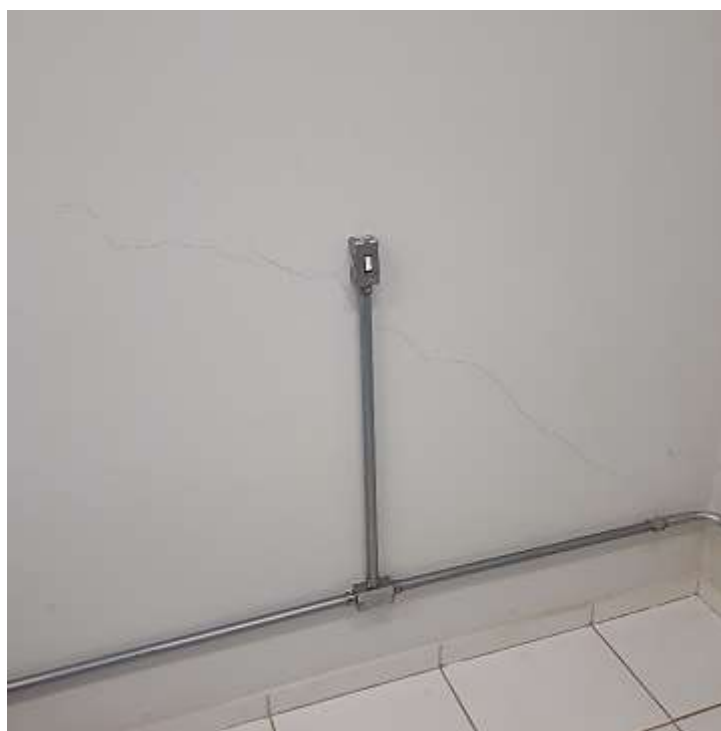
Figura 23: Trinca ocasionada pela movimentação da estrutura.
