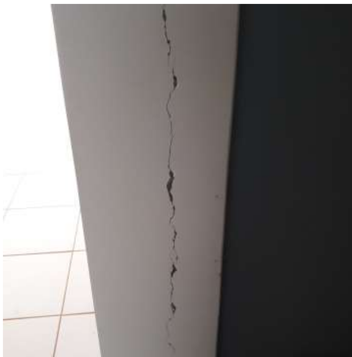
Figura 22: Trinca em alvenaria – 1º pavimento. Ocasionada provavelmente pela ausência de amarração dos blocos cerâmicos.
