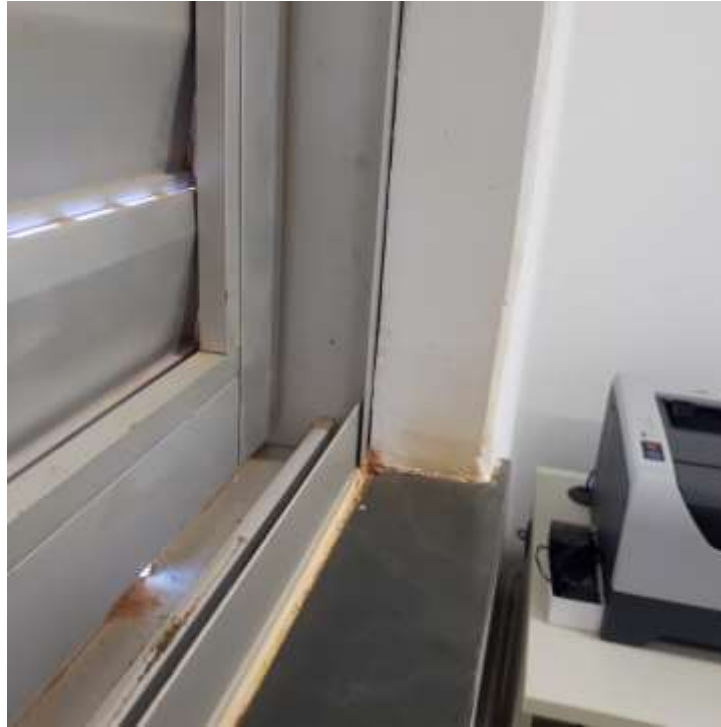
Figura 8: O silicone das esquadrias encontra-se danificado e deverá ser substituído.
