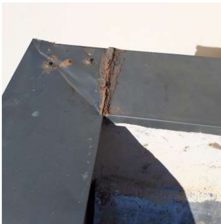
Figura 11: Emendas das pingadeiras com a vedação desgastada;
