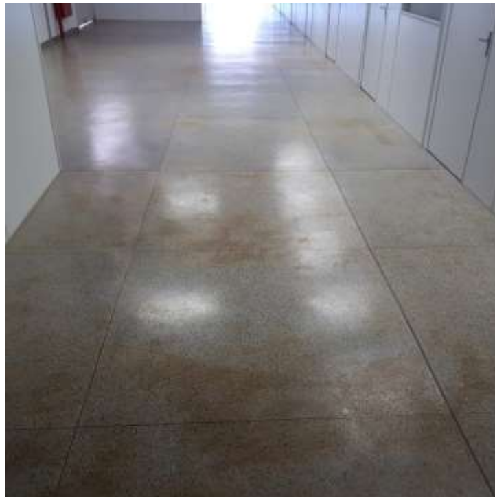
Figura 9: Manchas no piso em granitina
