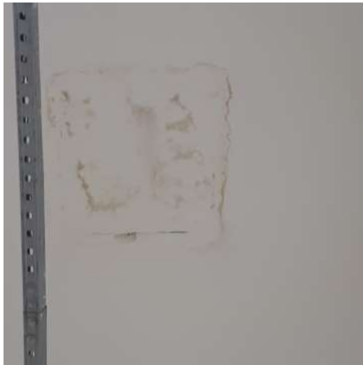
Figura 7: Marcas de infiltração no revestimento de teto
