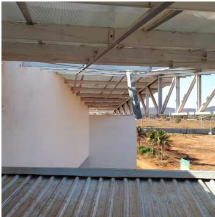
Figura 13: Desprendimento de telhas de policarbonato
