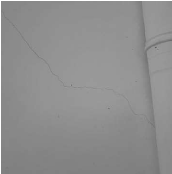
Figura 3: Paredes externas que necessitam de recuperação.
