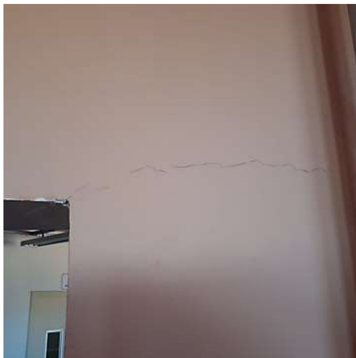
Figura 12: Trinca ocasionada pela insuficiência da verga.
