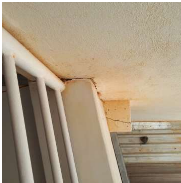
Figura 5: Viga estrutural com trinca superficial na zona de dilatação do prédio
