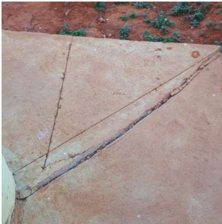
Figura 10: Necessidade de manutenção corretiva em pontos da calçada.
