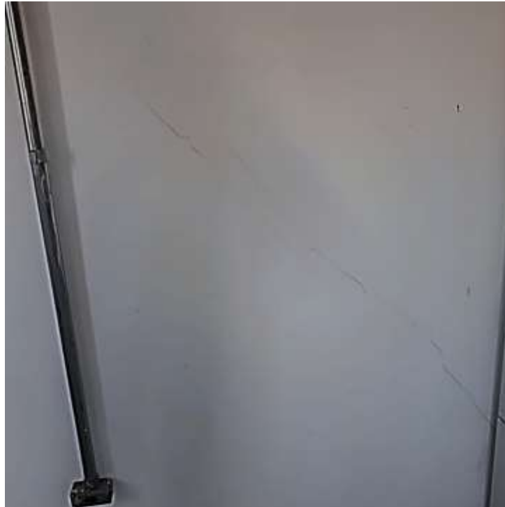
Figura 11: Trinca ocasionada pela movimentação da estrutura.
