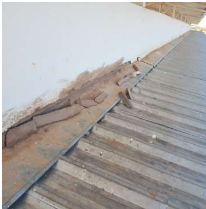
Figura 9: Desprendimento de rufo metálico
