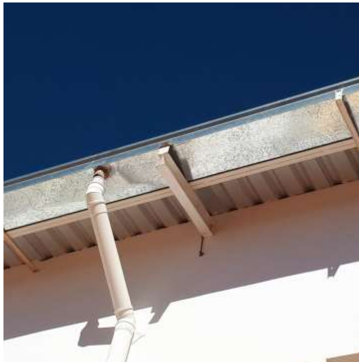
Figura 6: Desprendimento de calha junto à mão francesa
