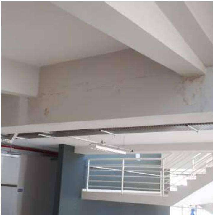
Figura 8: Andar inferior com marcas de infiltração devido a ausência de estanqueidade da Junta de Dilatação. O selante encontra-se ressecado.
