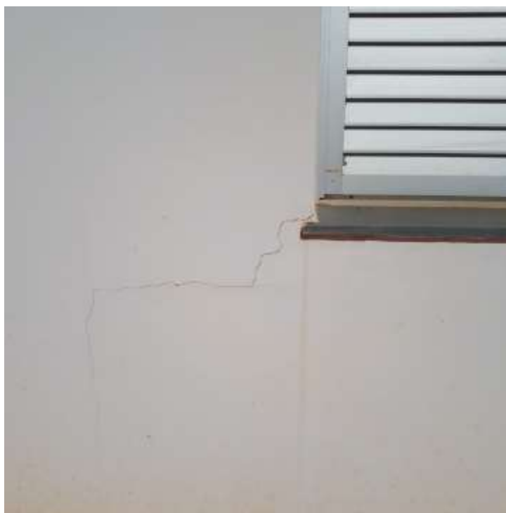
Figura 4: Paredes externas que necessitam de recuperação.
