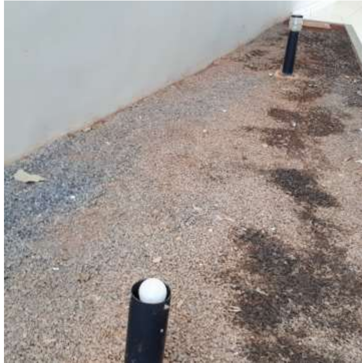
Figura 19: Ausência do vidro de proteção das lâmpadas dos balizadores
