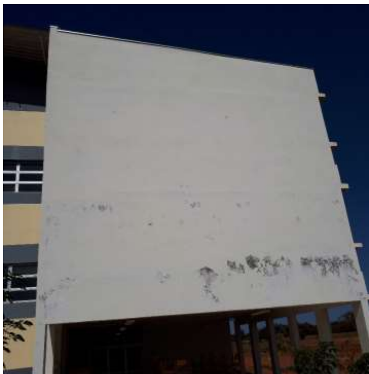
Figura 3: Paredes externas que necessitam de recuperação.
