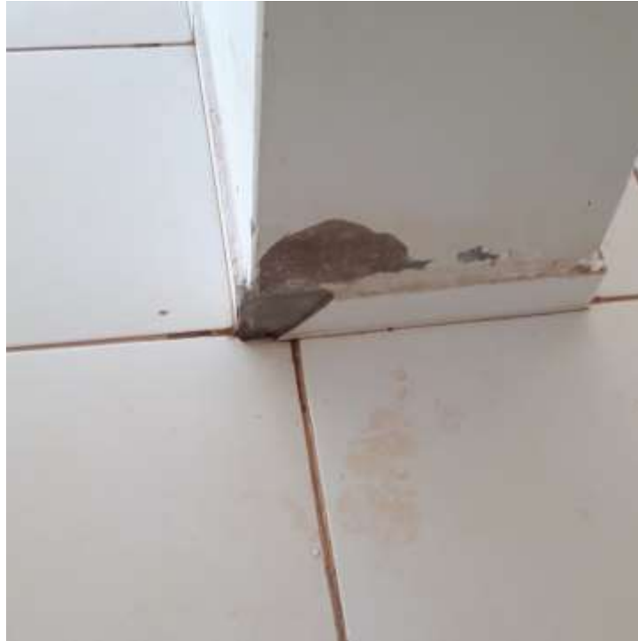
FIGURA 16: Rodapé danificado no pavimento térreo. Necessita de substituição
