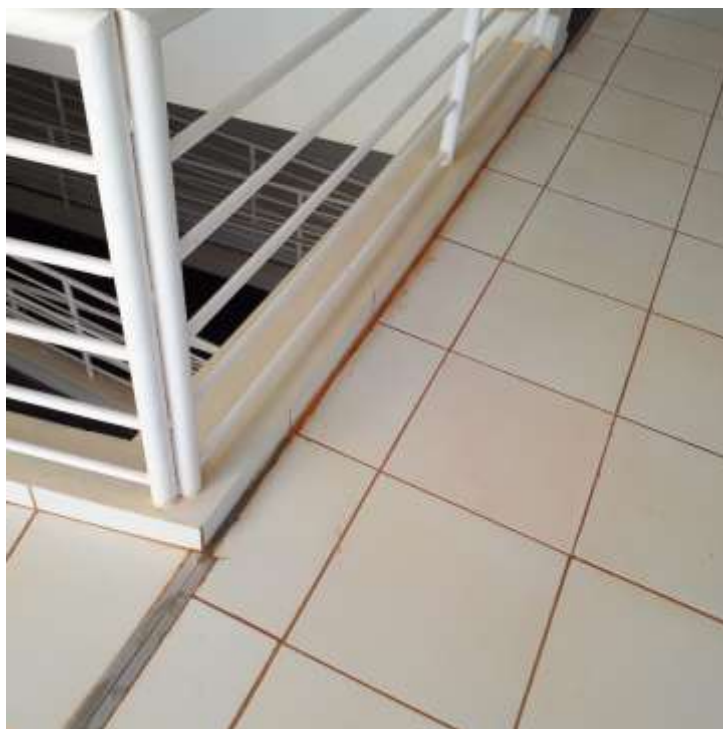
Figura 6: Junta de Dilatação necessitando de recuperação.
