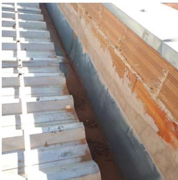
Figura 10: Calhas apresentando sujeiras em seu interior
