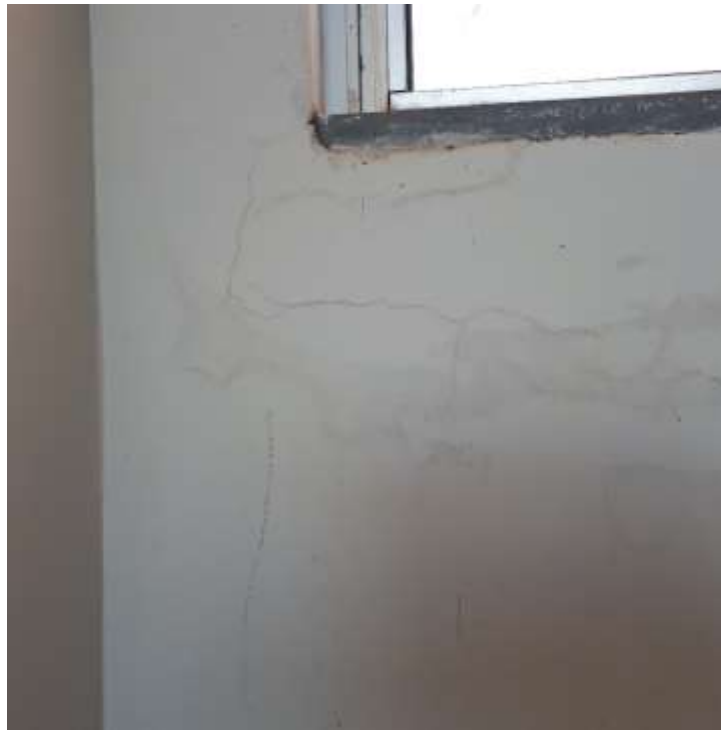
Figura 15: Marcas de umidade e presença de fissuras devido a ausência de vedação. O silicone deverá ser substituído.
