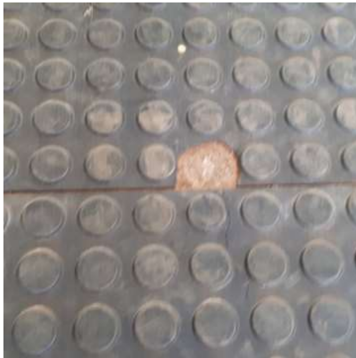
FIGURA 17: Placa do piso emborrachado danificada. Necessita de substituição
