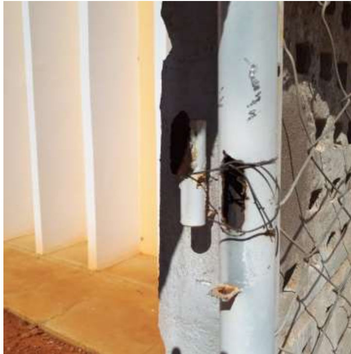
Figura 14: Portão em gradil necessita de reparos.
