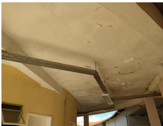
Figura 04: Laje do anexo da DTI que precisa ser pintada.
