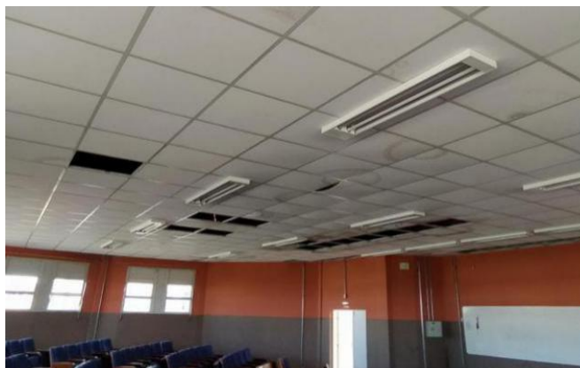
Figura 01: Condição do forro de um auditório.
