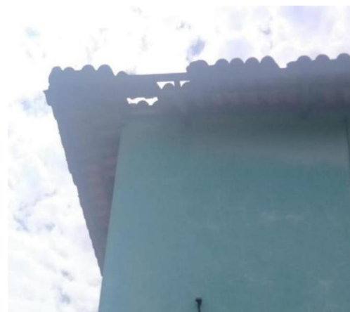
Figura 13: Situação do telhado da Fisioterapia.
