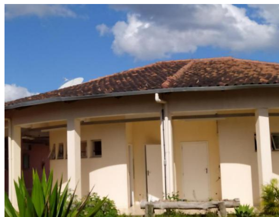
Figura 05: Telhado do anexo da DTI que deverá ser reparado.
