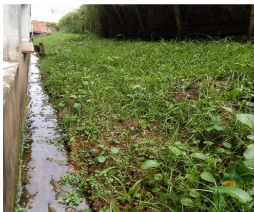
Figura 42: Infiltração. Prédio II. Campus I.
