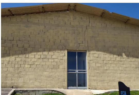
Figura 15: Trincas estruturais no prédio Herbário (FCA).
