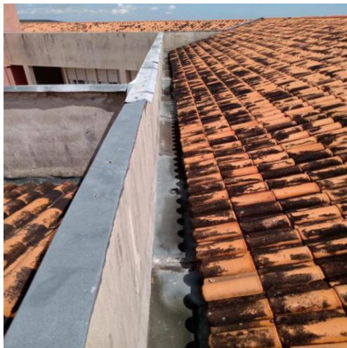
Figura 07: Situação das calhas no prédio do DCBio.
