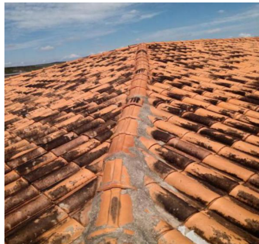
Figura 08: Situação da cumeeira no prédio do DCBio.
