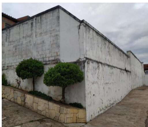
Figura 44: Infiltração em algumas salas do Prédio II – Campus I.
