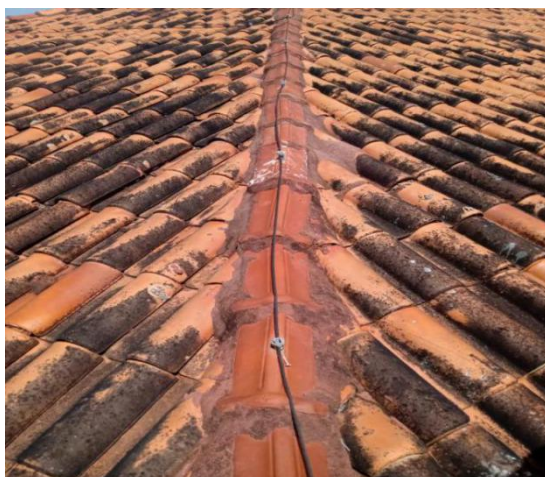
Figura 10: Situação do emboçamento das telhas no prédio da Educação Física.
