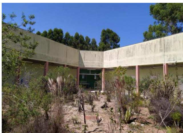
Figura 14: Área do prédio da Engenharia Florestal que precisa de manutenção no telhado.
