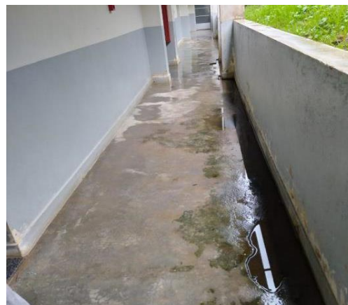
Figura 43: Infiltração no corredor do Prédio II – Campus I.
