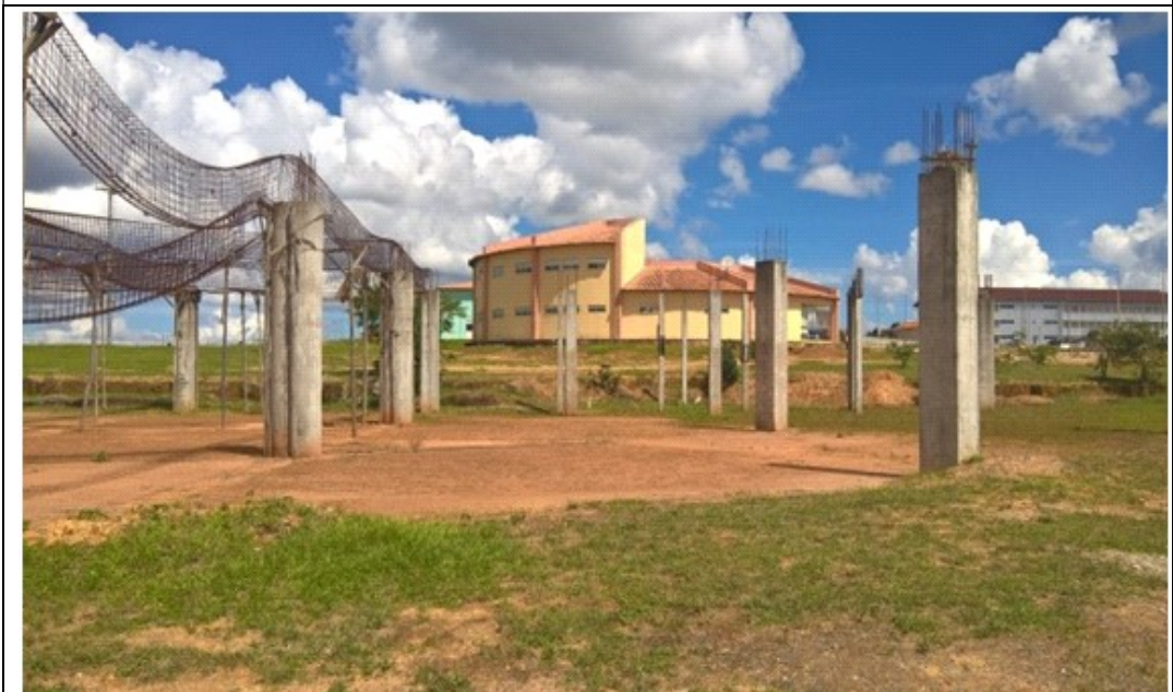
Figura 09: Vista do local com elementos executados. Ferragem exposta precisa de tratamento superficial com jateamento abrasivo. Conclusão será em conformidade com projeto existente que originou a parcela construída. Local com presença de vegetação e solo precisando de remoção.
