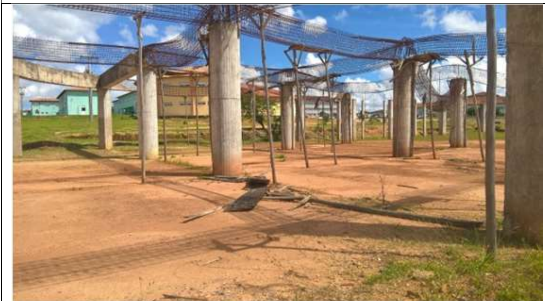
Figura 07: Elementos estruturais existentes. Os mesmos deverão ser preservados. Efetuar limpeza da superfície metálica e tratamento em juntas de dilatação. Elementos estruturais serão concluídos em conformidade com projeto existente.
