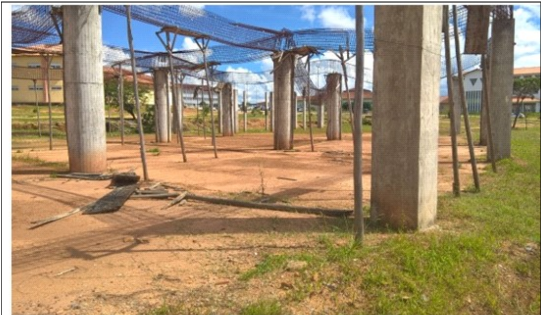
Figura 08: Elementos estruturais existentes. Os mesmos deverão ser preservados. Efetuar limpeza da superfície metálica e tratamento em juntas de dilatação. Elementos estruturais serão concluídos em conformidade com projeto existente. Na imagem, percebe-se vegetação no local e solo carreado.
