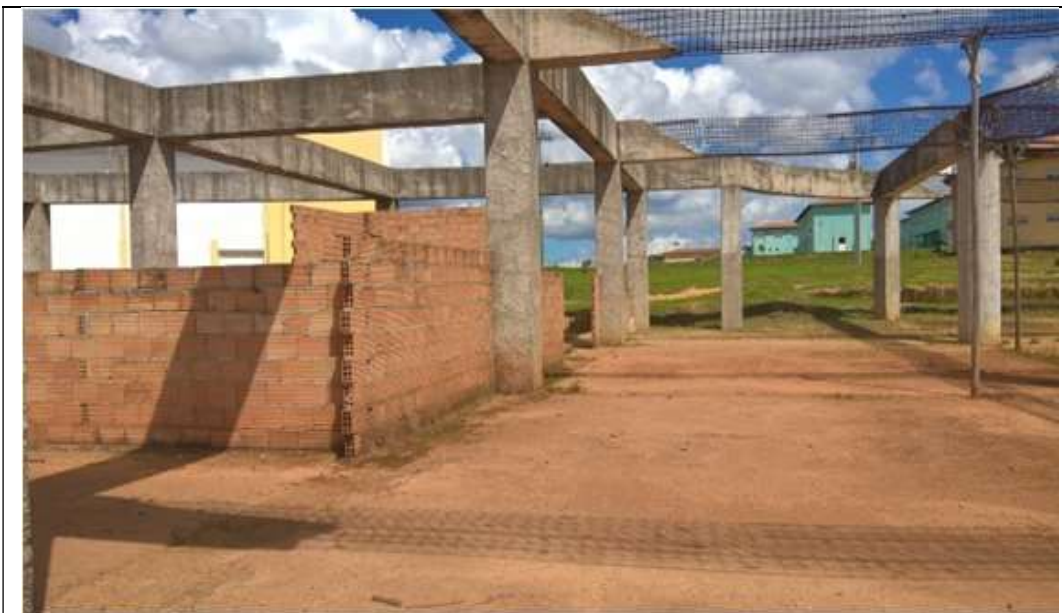
Figura 06: Alvenaria existente e elementos estruturais. A alvenaria passará por demolição. Elementos estruturais deverão ser preservados. Na parte onde se observa a alvenaria, há a presença de piso concretado o qual será demolido.
