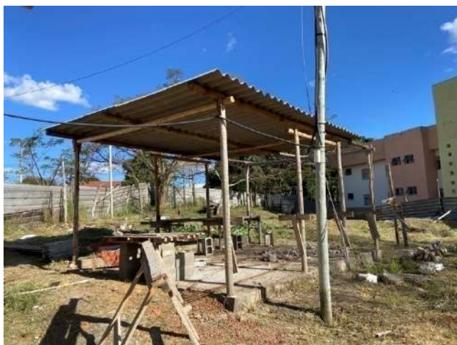
Foto 394: CENTRAL DE CORTE/MONTAGEM
