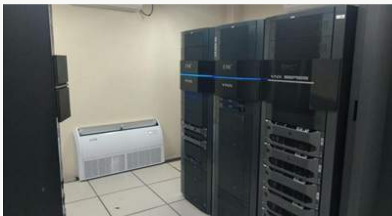
Servidores computacionais que hospedam o SEI, e-Campus, Portal etc. (Foto: DTI)
