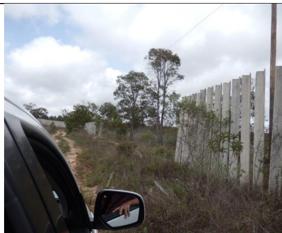
Foto 40 - Vista parcial do cercamento danificado (lado do Antigo poço do Negão)
