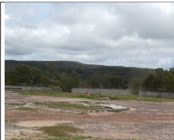
Foto 39 - Vista parcial do cercamento danificado (marginal BR367)
