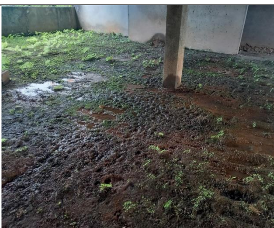
Foto 16- Vista interna do Conjunto 6 da Moradia Estudantil com umidade no chão
