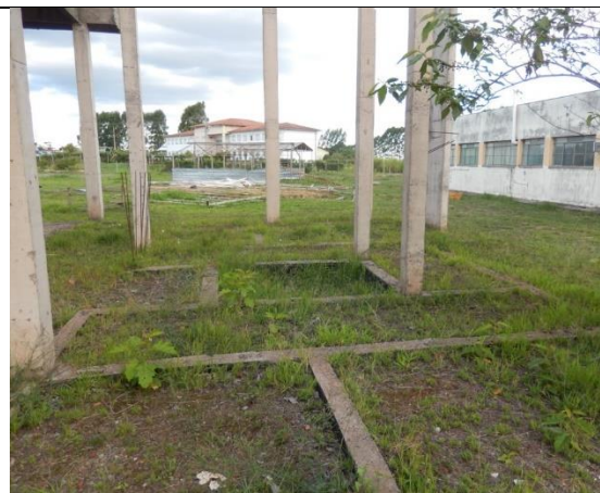
Foto 54 - Vista de vigas baldrame no local previsto para o prédio do CITEC
