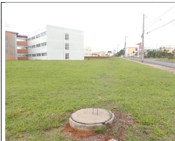
Foto 27 - Vista do ponto de visitaçao localizado na esquina da Av. Pedra Azul e rua D
